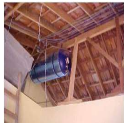
Foto 6- Reservatório fixado no vigamento do telhado Fonte: (CDHU, 2005a)
