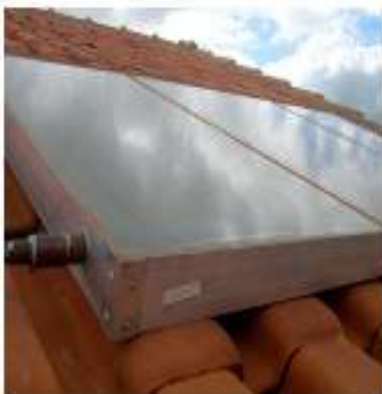
Foto 4- Coletores fixados sobre o telhado Fonte: (CDHU, 2005a)
